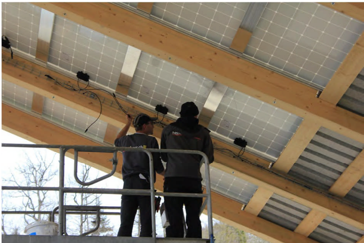
Abbildung 3 Verkabelung der von unten sichtbaren Module
