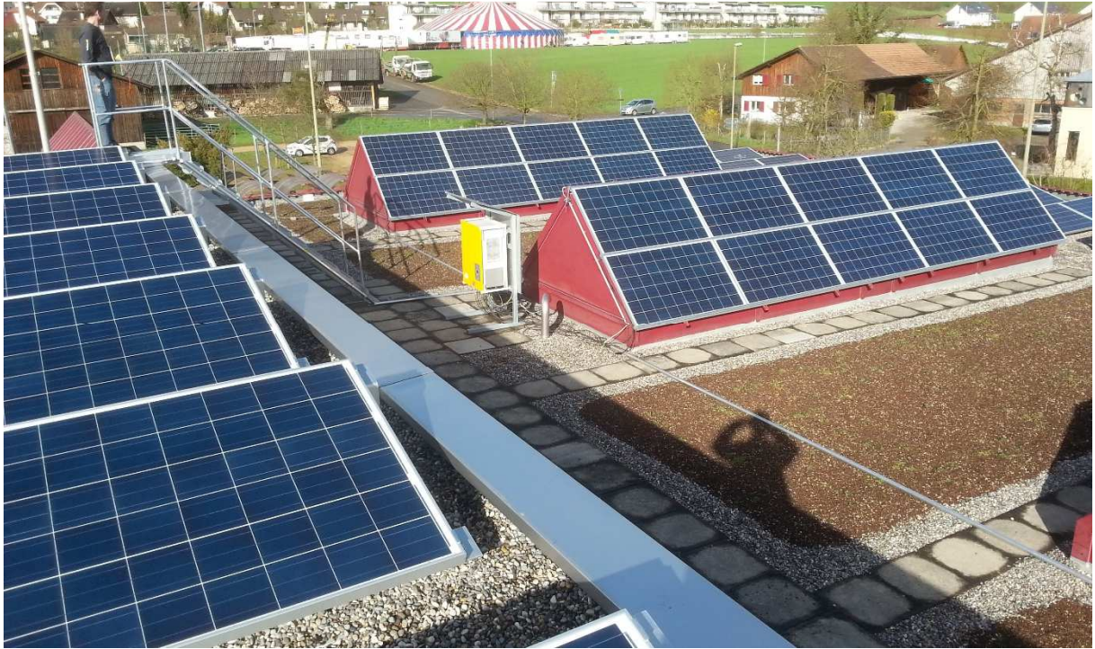
Abbildung 2: Wechselrichter mit Generatorfeldern
