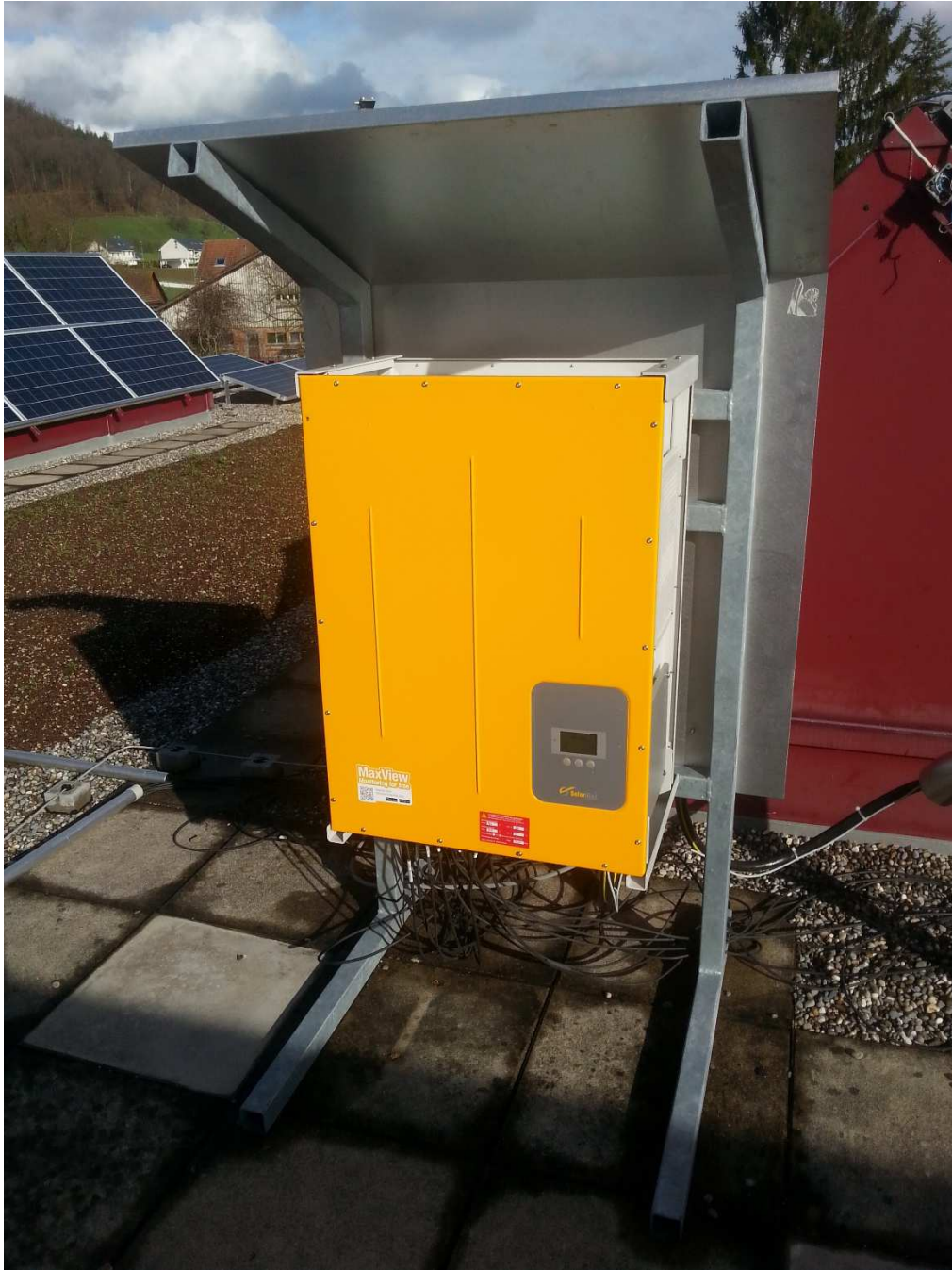
Abbildung 4: Wechselrichter mit Ständer. Standort im Freien bei den Generatorfeldern.
